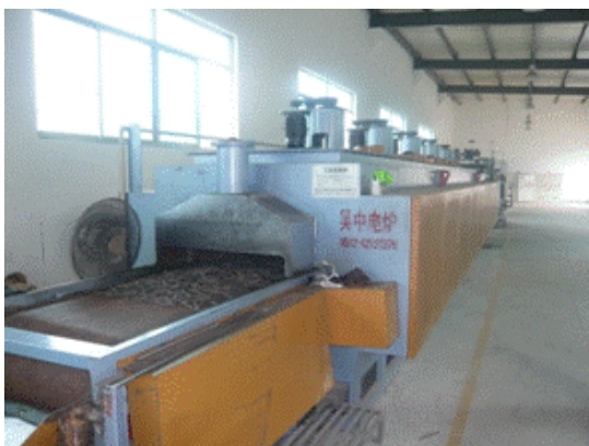
Entrée de la chaîne de traitement
