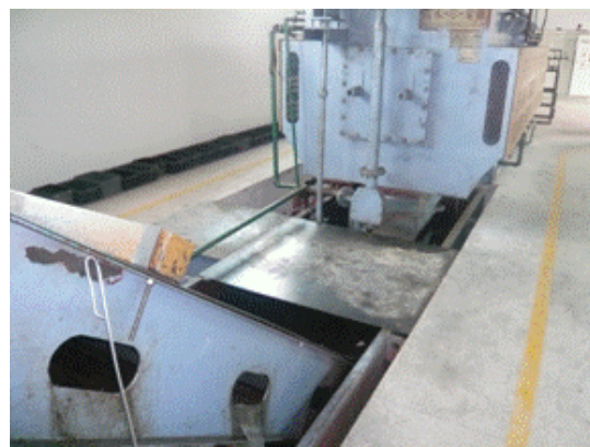
Bassin de la chaîne de traitement
