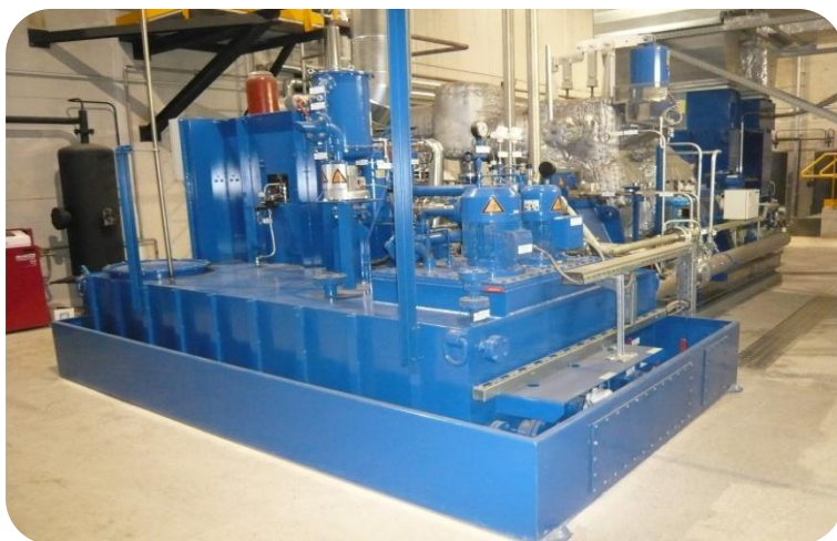
Centrale de Cogénération
