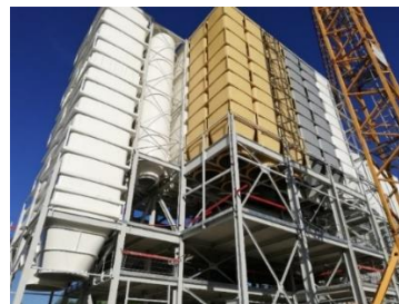
Tour de mélange de 43 silos
